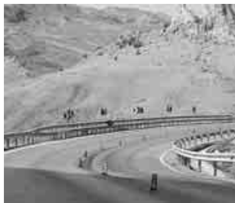
Il tratto in cui c'è un pericoloso dislivello nella carreggiata della Ss 190, in contrada Palladio
