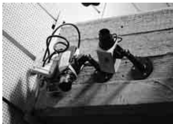
Le telecamere che saranno collocate permetteranno di bloccare le iniziative dei vandali e di coloro i quali creano le discariche abusive all'interno della cittadina
